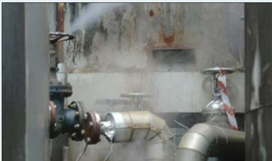
Oppstår det lekkasjer på kuldeanlegg i garantitiden kan dette medføre meget stor økonomiske konsekvenser.
