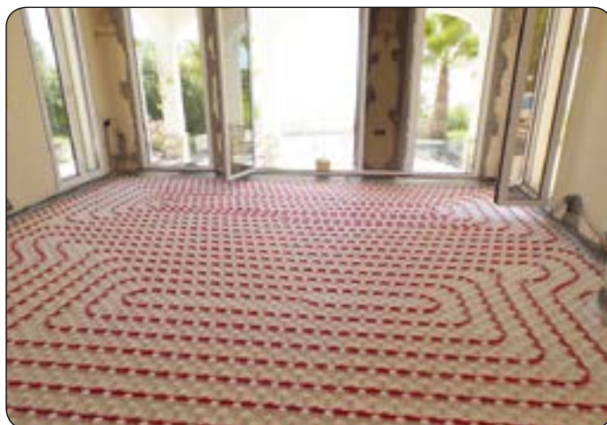
Det er gulvkaldt i spanske bygg og gulvvarme er helt nødvendig for sensible nordboere.
